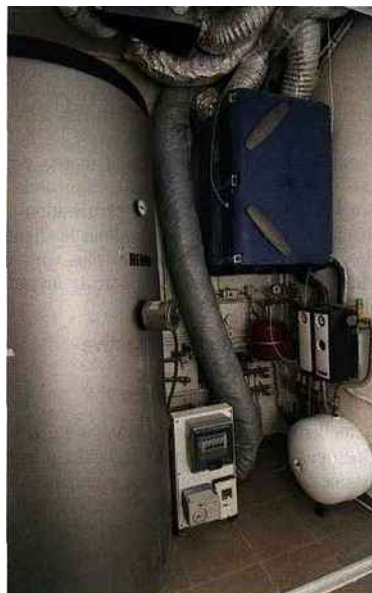
L'installation technique est logée dans un placard situé dans les WC. On distingue le ballon de 600 l, l'unité de ventilation double flux et sa liaison au puits canadien.
